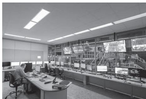
Рис. 11. Новый центральный пульт управления
