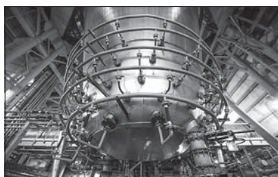
Установка вдувания ПУТ на ПАО «НЛМК» Фото: NLMK Group
